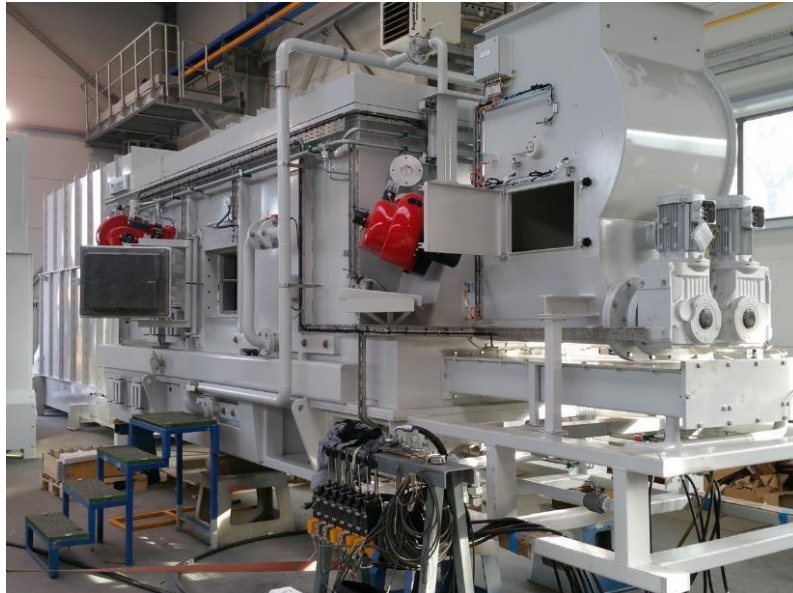
Unité de valorisation énergétique des déchets plastiques
